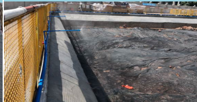
基坑喷淋系统
