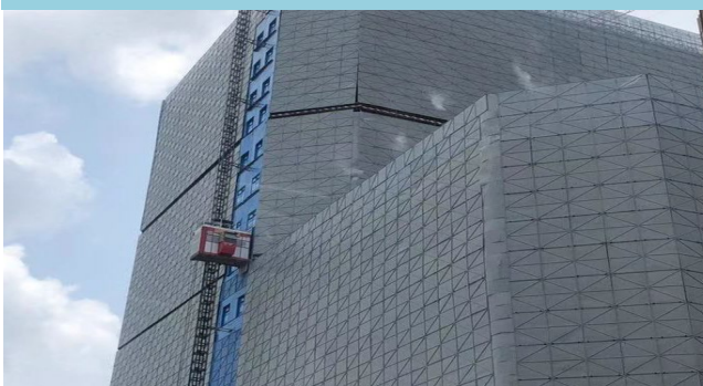
施工外脚手架喷淋系统
